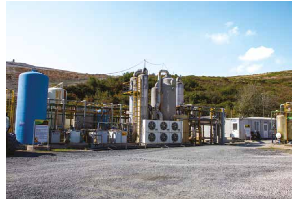
Vista Impianto trattamento del percolato
