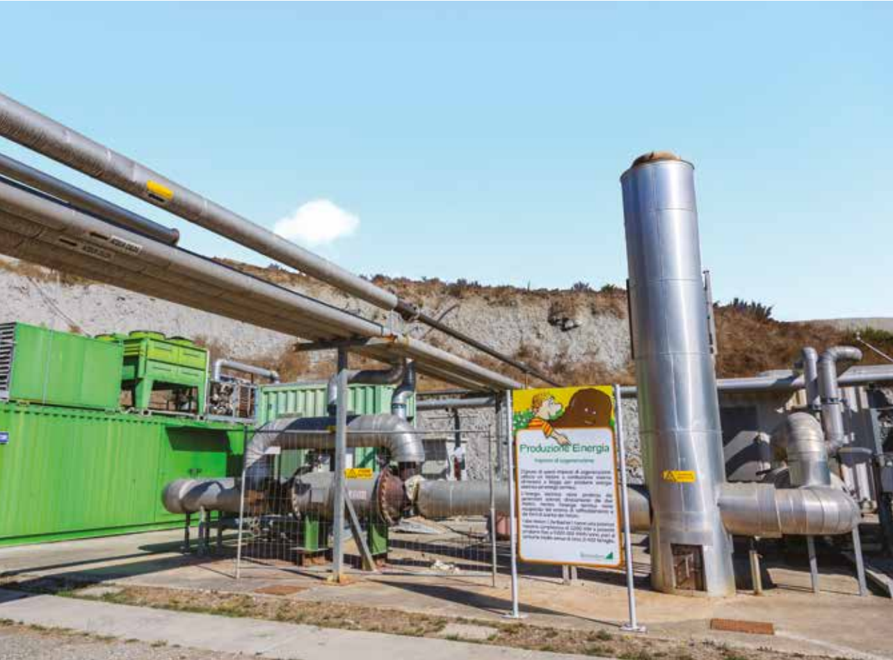
Vista di insieme impianto di cogenerazione
